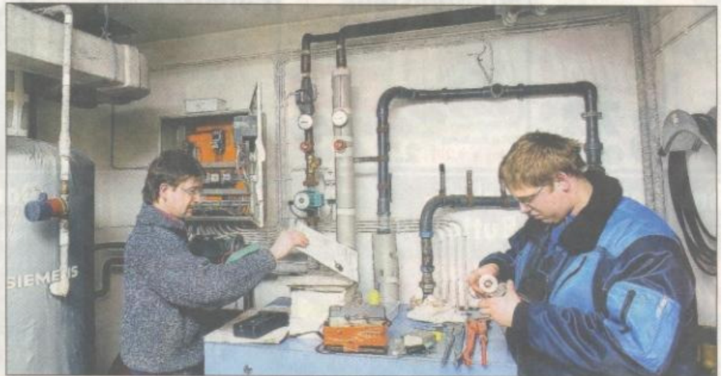
Die beiden Monteure Dirk Blankenmayer (links) und Marc Bier reparieren in Zweibrücken ein Heizungssystem, das nach dem Stromausfall aufgrund einer Überspannung beschädigt wurde. —FOJO: STEINMETZ
